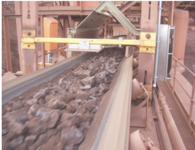
Figura 100 – Sensor instalado na correia transportadora onde as antenas de transmissão e recepção estão no mesmo plano.
